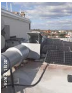
Panneaux photovoltaïques au Moulin de Brou
